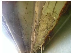
HP2016_PUTZ [1] S=1, V=0, D=3 EP BSP-ID 014-23 Platte, Doppel-T-Profil, Eine Stelle, Verrostet mit Querschnittsschwächung, Fläche: 0,25 m2, Oberstrom links, Erster Längsträger oberstromseitig. Im diesem Bereich sind auch erhebliche Aussinterungen zu erkennen. - Länge: 2,000 m
