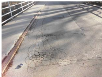
HP2016_RISSE MIT BELAGSAUSBRÜCHE
